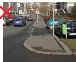
111 Nevhodné řešení křižovatky hlavní a vedlejší ulice s přerušenou kontinuitou chodníku [ Praha 10, Moskevská ]
