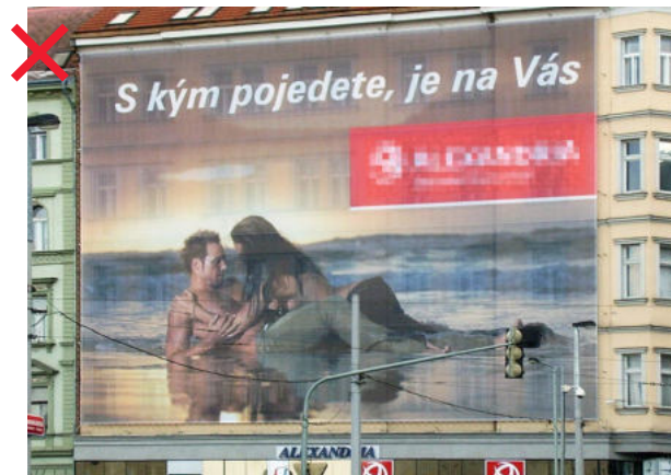
574 Plachta zakrývající fasádu objektu mění vzhled budovy, znemožňuje její plnohodnotné užívání a ohrožuje bezpečnost provozu [ Praha 3, Vinohradská ]
