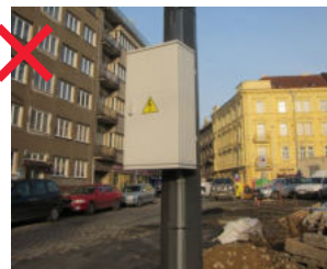
247 Prvek umístěný na jiném prvku nerespektuje barevnost a povrchovou úpravu prvku nosného [ Praha 10, Moskevská ]
