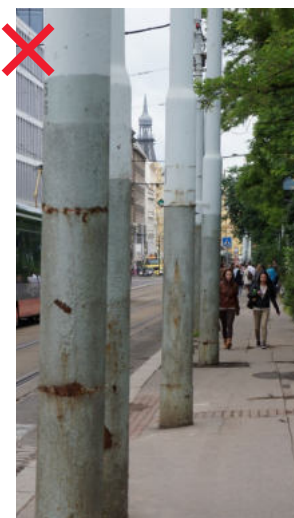
370 Nekoncepční umístování sloupů trakčního tramvajového vedení do prostoru chodníku pouze dle požadavků na statiku vytváří bariéry pro pohyb po chodníku a degraduje celkové vnímání prostoru náměstí [ Praha 2, Karlovo náměstí ]
