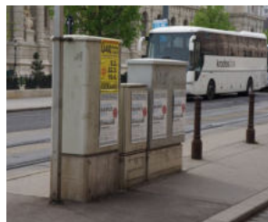
365 Skříňně technické infrastruktury je vhodné umísťovat v ose sloupů, kde nepřekáží v prostoru, případně přecházení ulice [ Rakousko, Vídeň ]
