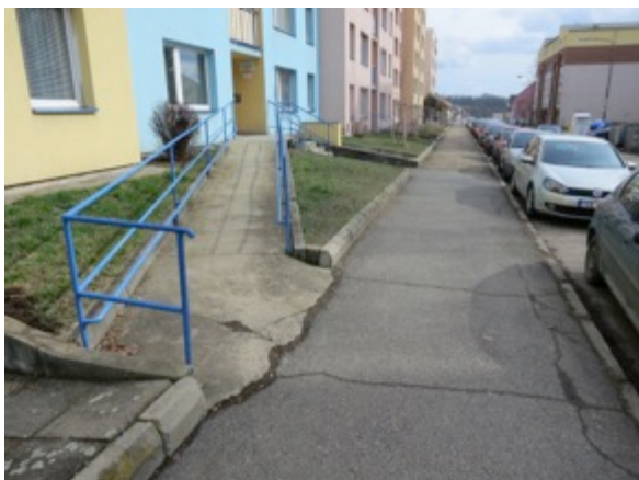
Nevhodná kombinace materiálů a řešení detailu rozhraní. [ ul. Vlašimská ]
