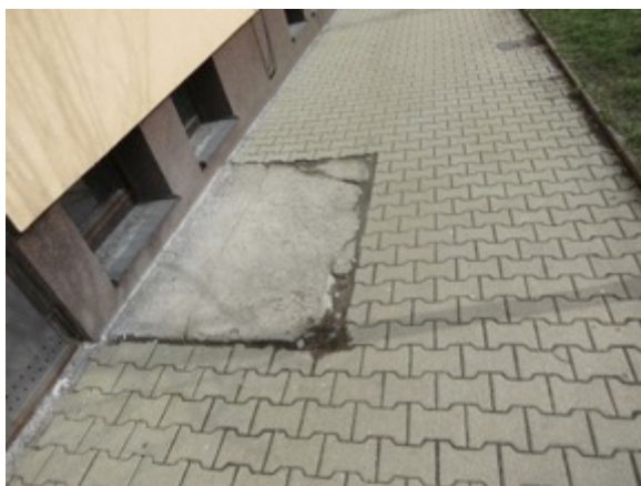
Oprava povrchu nesmí být prováděna odlišným materiálem. [ ul. Žižkova ]
