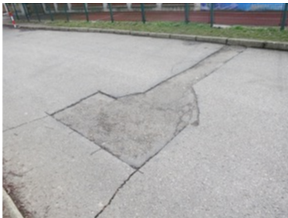
Příklad nevhodného zásahu do asfaltu. [ ul. Jiráskova ]
