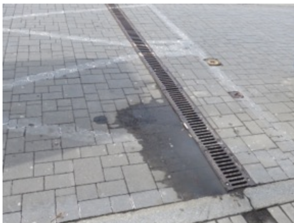
Deformace rovinnosti povrchů způsobují špatné odvodňování ploch a následnou degradaci materiálů v postižených místech. [ Masarykovo náměstí ]
