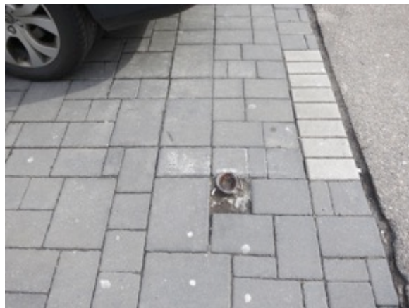
Příklad provizorního (po čase definitivního) řešení. Mimo finanční aspekt nutno zvážit i hlediska bezpečnosti a estetiky. [ Masarykovo náměstí ]
