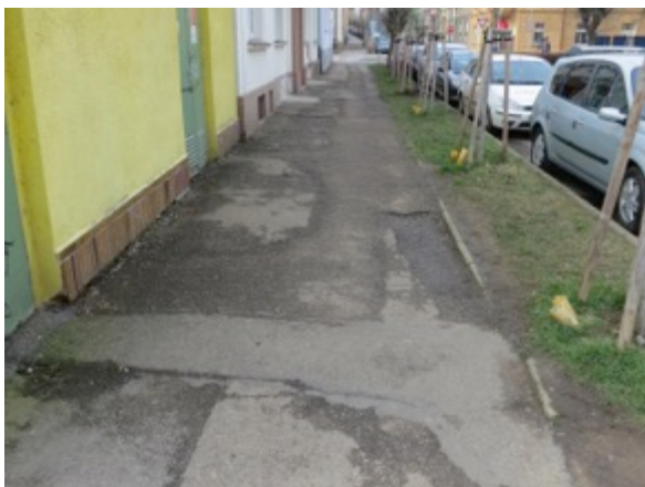
Záplaty v asfaltu. [ ul. Jiráskova ]
