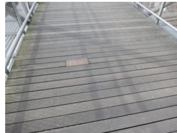
Z provizorní opravy – plech na dřevo - se stává trvalý stav. [ pěší lávka přes železniční trať ]
