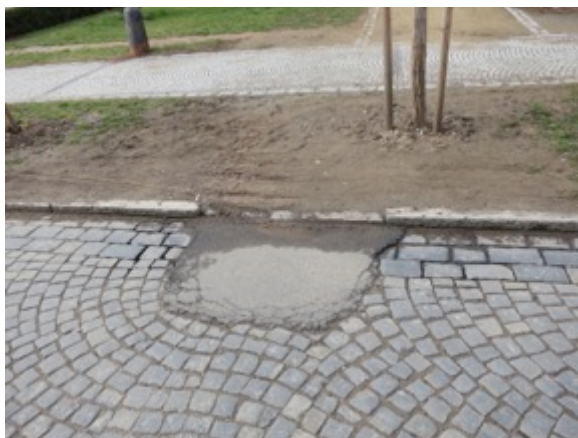
Žulové kostky – kvalitní kamenná dlažba degradovaná necitlivými "opravami" asfaltem. [ ul. Husova ]
