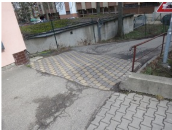
Nesourodá směs materiálů i barev v kombinaci s technolog. nekázní při provádění vede k rychlé morální i fyzické degradaci. [ ul. Nádražní ]
