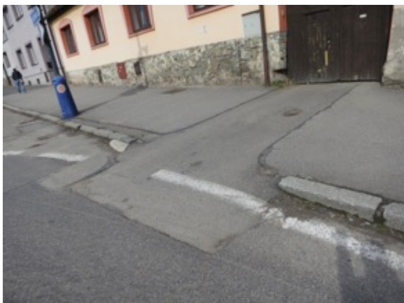
Příklad nevhodného provedení sjezdu na komunikaci. Chybí naklop. obrubník, způsob opravy asfaltu zásah spíše akcentuje. [ ul. Vlašimská ]
