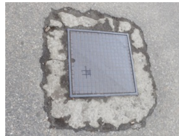
Nevhodná oprava odlišným materiálem. Absence kontroly ke zjednáání nápravy. [ Benešov ]
