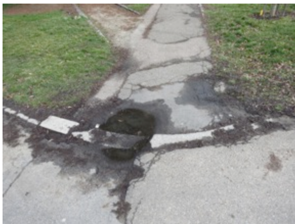
Stav chodníku, kdy je již zdraví nebezpečný. [ Husovo náměstí ]
