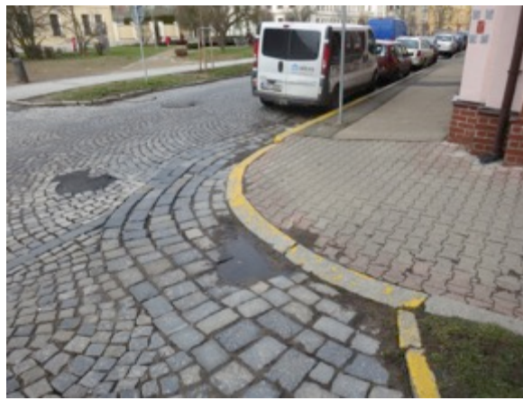
Žulové kostky – kvalitní kamenná dlažba degradovaná necitlivými "opravami" asfaltem. [ ul. Husova ]
