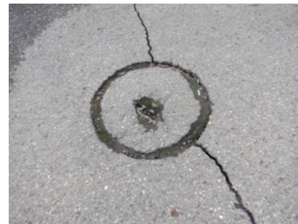
Nesprávné provedení asfaltu kolem kanalizačního poklopu. [ Benešov ]
