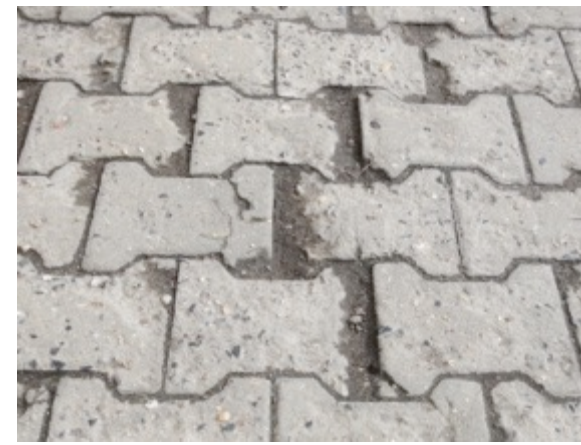
Destrukce zámkové dlažby po několika letech užívání. [ chodník mezi Masarykovým a Malým náměstím ]
