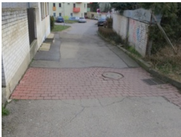
Nevhodná oprava povrchu odlišným materiálem, zde navíc ještě zvýrazněna odlišnou barvou. [ pěší průchod vnitroblokem mezi ul. Nádražní a Husova ]
