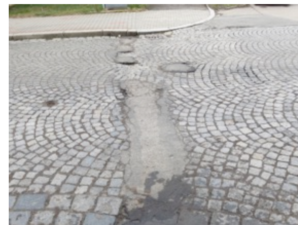
Oprava povrchu nesmí být prováděna odlišným materiálem. [ ul. Husova ]
