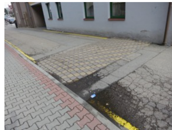
Nekoordinované dílčí zásahy vedou k materiálové a barevné nejednotě. Způsob oprav asfaltu urychluje degradaci celku. [ boční ulička při Tyršově ulici ]
