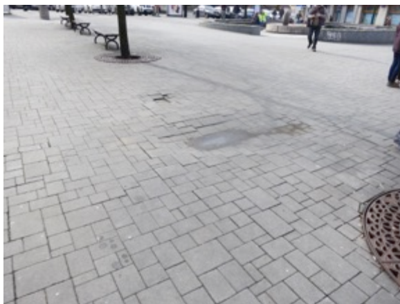
Průlehy v dlažbě jsou důsledkem technologické nekázně při realizaci nebo špatným projektem nebo kombinací obojího. [ Masarykovo náměstí ]
