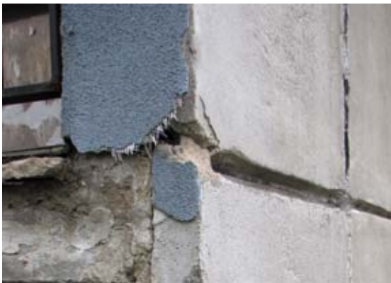
Obr. 3 Popraskaná omítka v místech, která nejvíce trpí promrzáním na styku tepelných mostů u lodžii, zde omítka nejdříve opadala z čela panelu, rozpraskaného i do hloubky.
