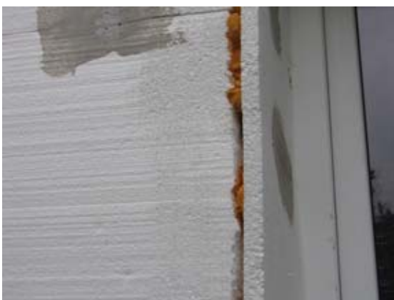
Obr. 23 Minimální zateplení špalety 20mm EPS je navíc znehodnoceno tím, že lepicí PU pěna nevyplňuje celou styčnou lepenou spáru (a pravděpodobně ani plochu) a je narušena dalším zbytečným tepelným mostem kotev.
