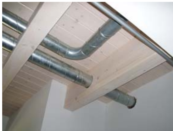
Rozvody vzduchu pod stropem
