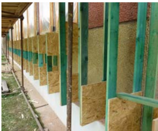
Obr. 8 Princip zavěšené fasády, řez a realizace. Do připraveného roštu, nejčastěji na bázi dřeva, je vkládána izolace, jako fasádní úprava pak může být volena omítka na nosiči (např. dřevovláknitá nebo heraklitová deska) či obkladový materiál s provětrávanou mezerou (zdroj CPD).
