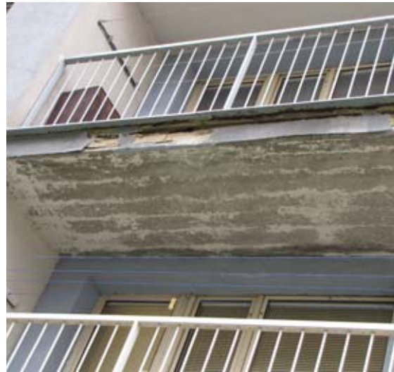
Obr. 4 Panel mezi patry lodžii trpí nevyváženým průběhem teplot v mrazivém období; nejdříve se může projevovat narušením krytí výztuže.
