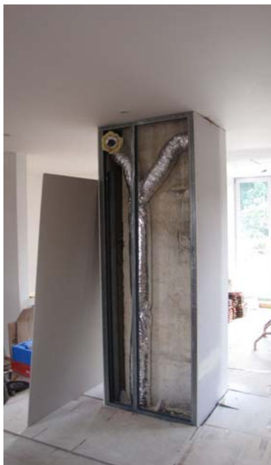
Rozvod větracího systému umístěný do rozšířeného komínového tělesa
