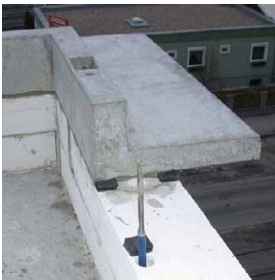
Obr. 12 Příklad tepelné izolace atiky u konstrukce obrácené střechy (zdroj Treberspurg & Partner Architekten).
