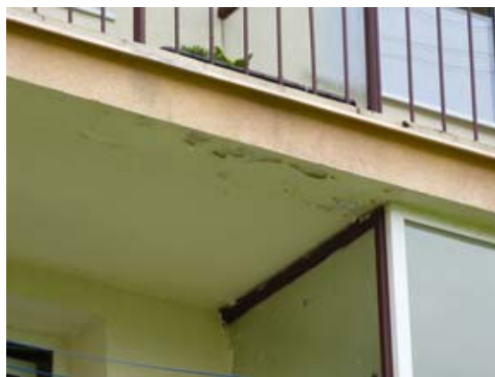
Obr. 51 Z jiné stavby: stav promrzající části lodžie po jedné zimě od opravy.
