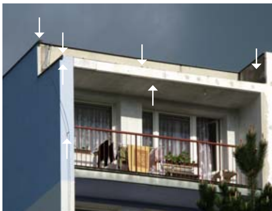
Obr. 47 Lodžie referenční stavby v posledním patře se sedmi nedořešenými detaily tepelných mostů.
