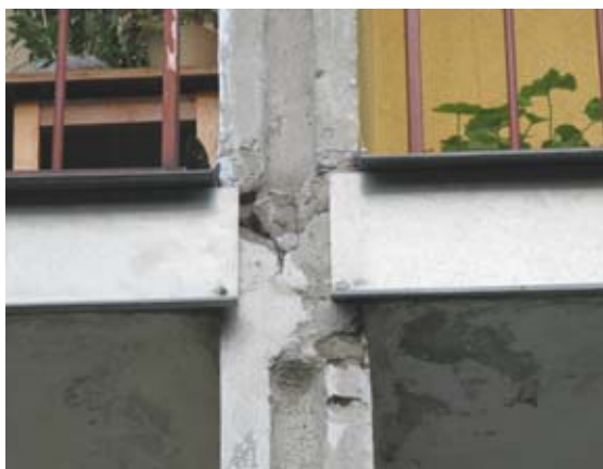
Obr. 48 Příprava oplechování na podlaze lodžie bude jen více vyostřovat teplotní rozhraní zateplené hrany a nezateplené stěny.
