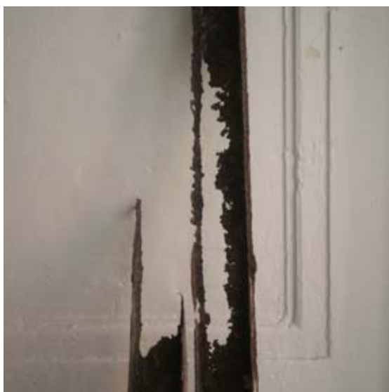
Ocelová konzola nesoucí balkon - stav zjištěný po odkrytí betonové desky balkonu (stáří cca 100 let), foto Transat architekti
