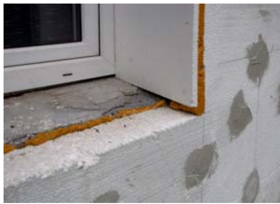
Obr. 22 Neřešitelný detail tepelného mostu parapetu, pokud nemá dojít ke změnám v interiéru bytu, protože pod parapetním plechem není místo na jakoukoli izolaci a navíc zcela chybí jakékoli těsnicí prvky ve styku okna a ostění (pásky nebo komprimační těsnění).
