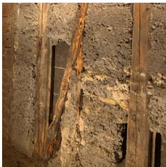
Hrázděná stěna - stav zjištěný po odkrytí neprodyšné vrstvy ze strany interiéru v koupelně (stáří cca 100 let), foto Transat architekti
