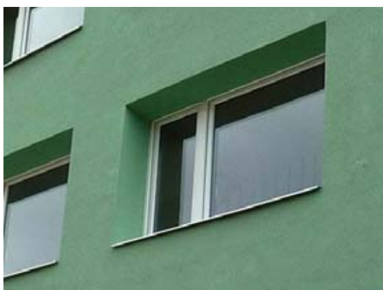
Obr. 28 Výsledný stav hluboké špalety po zateplení s okny v původní rovině mimo rovinu tepelné izolace.
