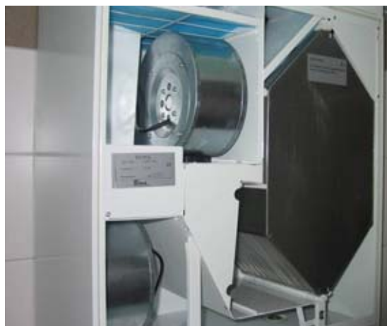
Obr. 19-20 Efektivní větrání prostor lze zabezpečit i decenterálními jednotkami. Umístění jednotky (vlevo) je zde řešeno jednoduchým způsobem do podhledu v prostoru chodby s malými nároky na prostor, s minimálním počtem a délkou rozvodů. Vpravo umístění jednotky v koupelně (zdroj Solanova Consortium, CPD).
