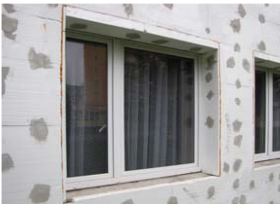
Obr. 21 Hluboká špaleta nedostatečně zateplené fasády s novým oknem na původním místě s nevyváženě řešením (nepatrně, málo a zcela neřešeným) tepelným mostem ostění.
