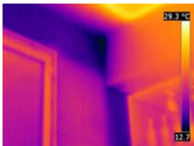
Teplotní most v místě železobetonové konstrukce, zdroj A.W.A.L., s.r.o.
