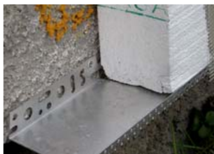
Obr. 9 Ukončení tepelné izolace nad zemí vodivou základací lištou a nedostatečně uzavřenou mezerou na patě domu.
