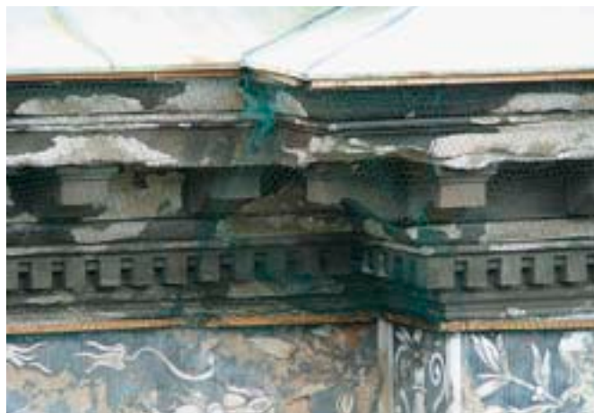
Detail odpadávající korunní římsy, provizorně zajištěné sítě
