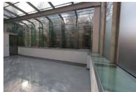
Přístavba zimní zahrady / Architekt vily Kamil Roškot, Praha - PETR FRANTA ARCHITEKTI & ASOC. Petr Franta - 2013/05
