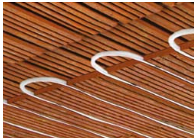
STROP PŘED OMÍTNUTÍM
