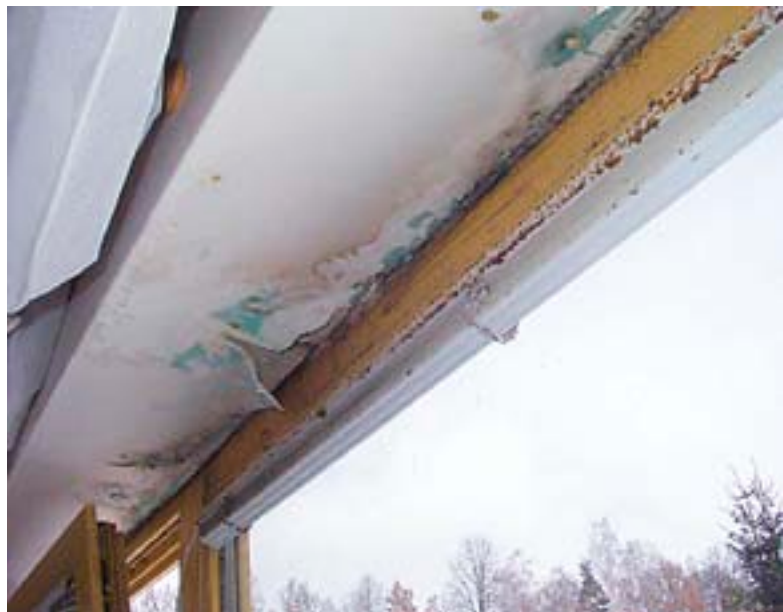
Interiér jednoho z bytů kolonky Rudník v Podkrkonoší, architekti při návrhu a realizaci nerespektovali elementární zásady stavební fyziky a stavitelství. Stavba obdržela cenu Grand Prix v roce 2001, dodnes není pro četné vady zkolaudována (jeden z prvních pomníků české moderní architektury). Foto: Awal
