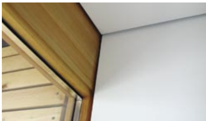
4. Sesychání a dotvarování dřevěné konstrukce vede obvykle zejména v prvních letech po dokončení stavby k praskání sádrokartonových konstrukcí v interiéru. To lze eliminovat oddělením všech rovin a konstrukcí příznanou spárou. Finančně náročnější, ale velmi efektivní řešení.
