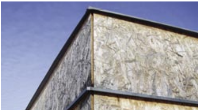
5. Ke koloritu projektování dřevostaveb v Česku patří používání interiérových OSB desek na fasádě. Je tím nejen porušeno pravidlo bezpečné, difúzně otevřené skladby konstrukce obvodového pláště (deska tvoří parozábranu na vnějším líci), ale rovněž výrazně snížena životnost stavby ku škodě klienta.
