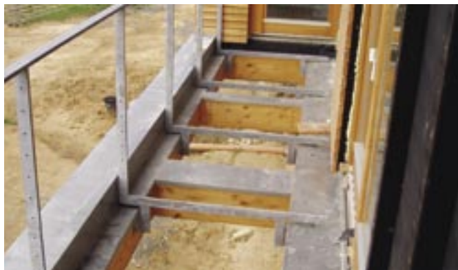
2. Citlivým detailem je vnější terasa a kotvení sloupků zábradlí. Na příkladu stavby jsou kotvy sloupků důsledně chráněny okapnicemi oplechování nosných profilů. Vyjímatelé panely podlahy jsou potom ukládány na pružné podložky.
