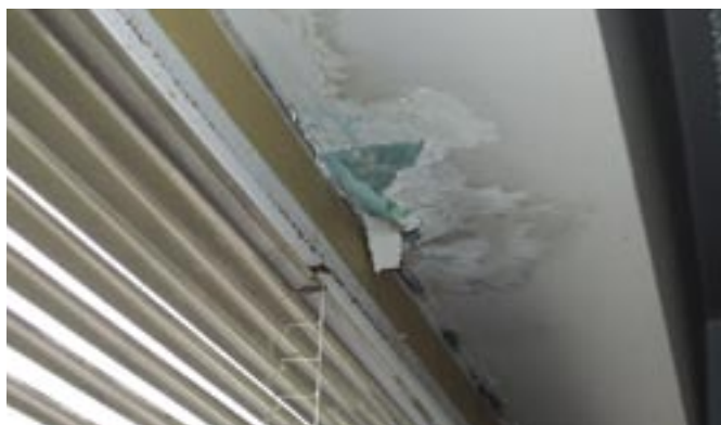
8. Důsledky řešení dokumentovaného na obr. 7 pro klienty již po několika zimách. Dochází k degradaci obnaženého rámu okna. Rozsáhlý tepelný most vede ke kondenzaci vlhkosti, přes montážní pěnu do interiéru zatéká, v nadpraží se tvoří obtížně odstranitelné plísň...
